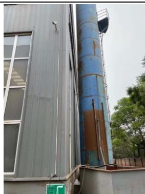
DA003 排气筒（锅炉）
