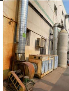
DA002 排气筒（喷淋塔+活性炭吸附+UV光氧）
